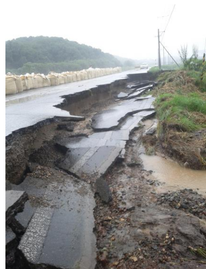
道路決壊時の状況
