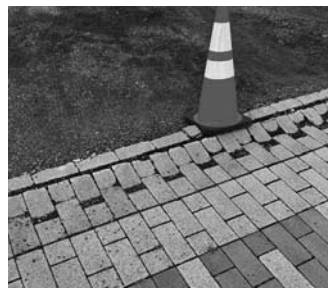
なかなか進まない補修
