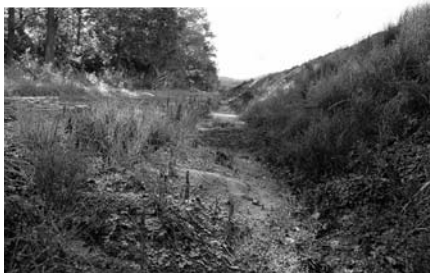
農道とほとんど差がない排水溝
