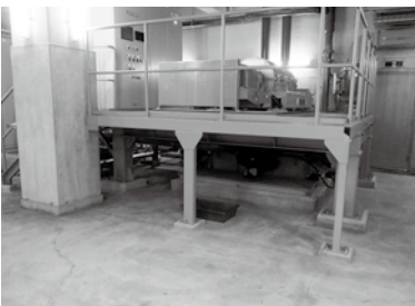
下水汚泥脱水機
