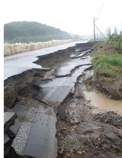
道路決壊時の状況
