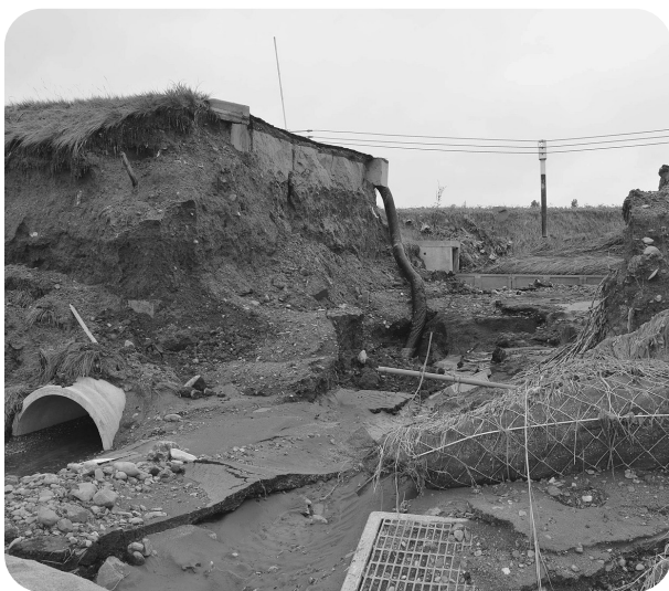
2年続けて大雨被害にあった西33号線
